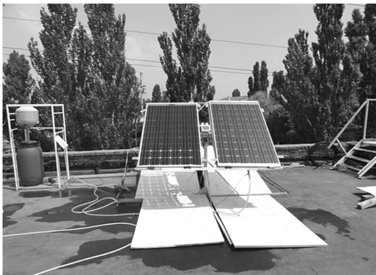
Рис. 2. Гибридная солнечная энергетическая установка
