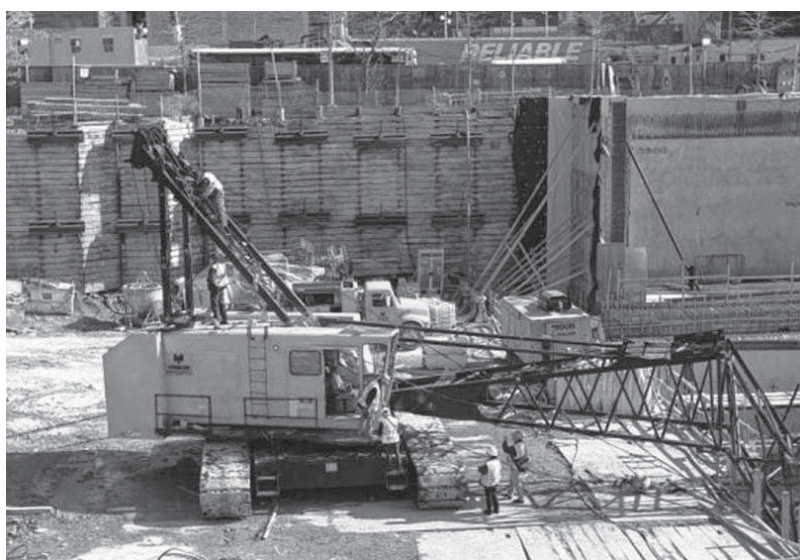
Рис. 3. Будівельний стріловий кран на гусеничному ходу, обрив стрілового каната якого призвів до загибелі 30-річного робітника
