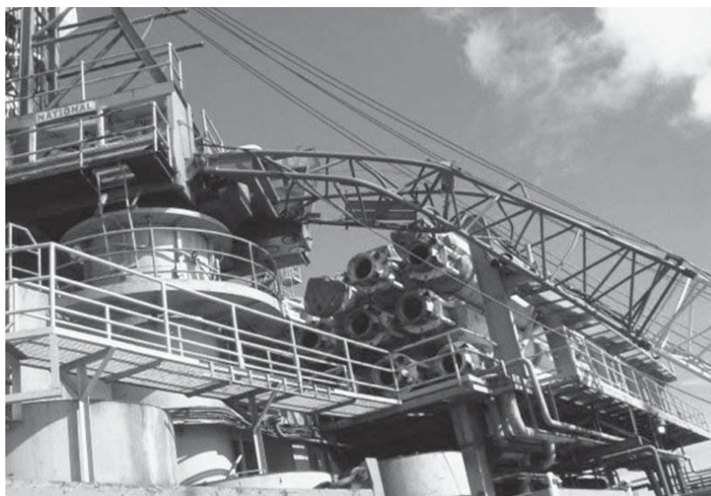
Рис. 2. Офшорний кран National обрив стрілового каната якого призвів до аварії та втрати обладнання
