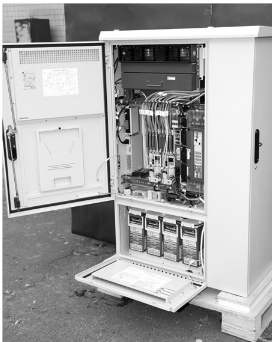
Рис. 2. Активный телекоммуникационный шкаф Huawei
